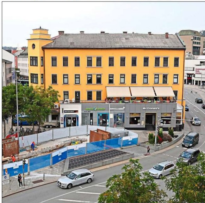
Das stadtbekannteste „Buchner-Haus“ am Ludwigplatz steht demnächst zur großen Modernisierung an. Dabei soll auch der enge Gehweg zwischen Straße und McDonalds-Eck (rechts) verbreitert werden. – Fotos: Jäger
